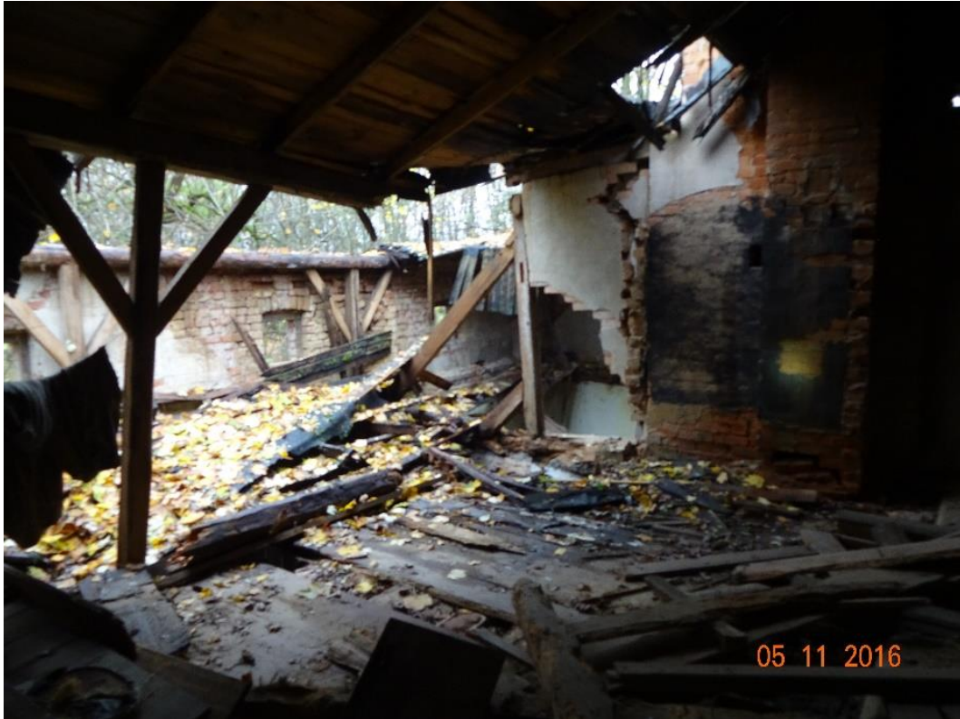
Fot. 20. Widok zarwanego dachu budynku
