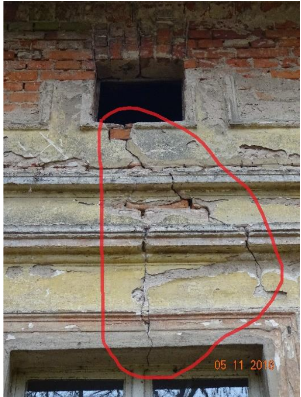
Fot. 12. Fot. 13. Pęknięcia ścian zewnętrznych R6 i R4
