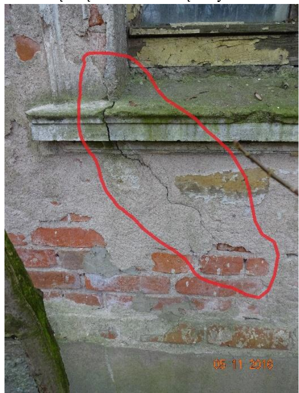
Fot.14. Fot.15. Pęknięcia ścian zewnętrznych R10 i R5
