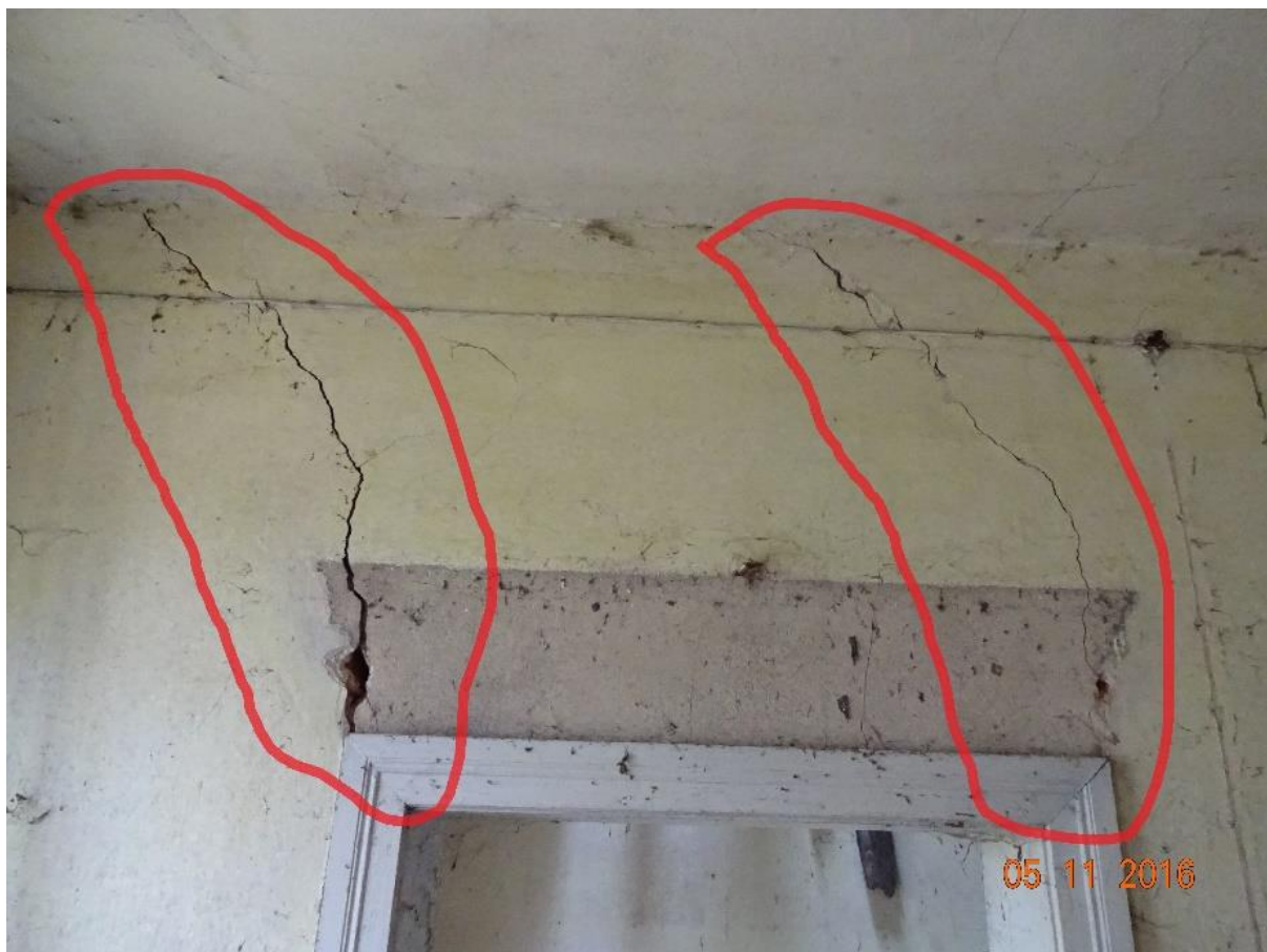
Fot. 16. Pęknięcia ścian wewnętrznych R13, R14
