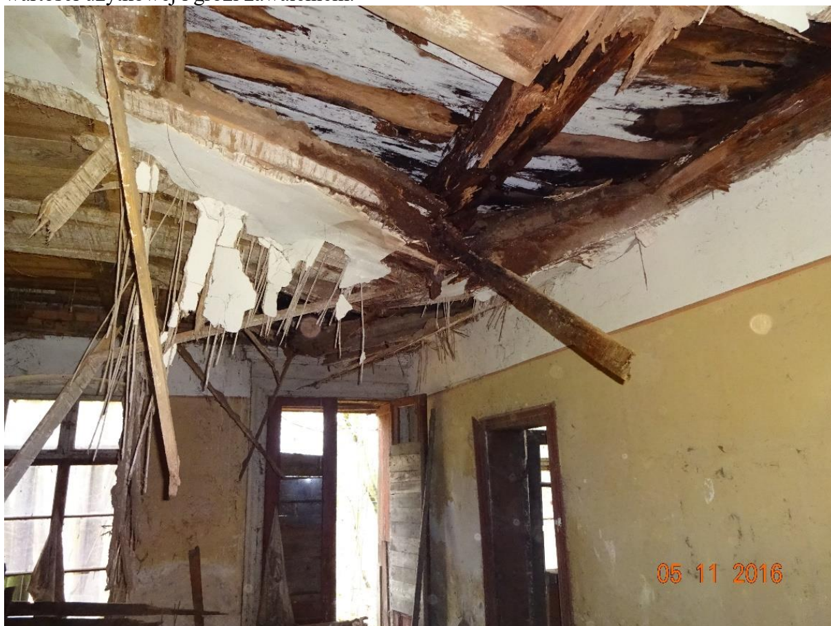
Fot. 17. Widok zarwanego stropu drewnianego nad parterem
