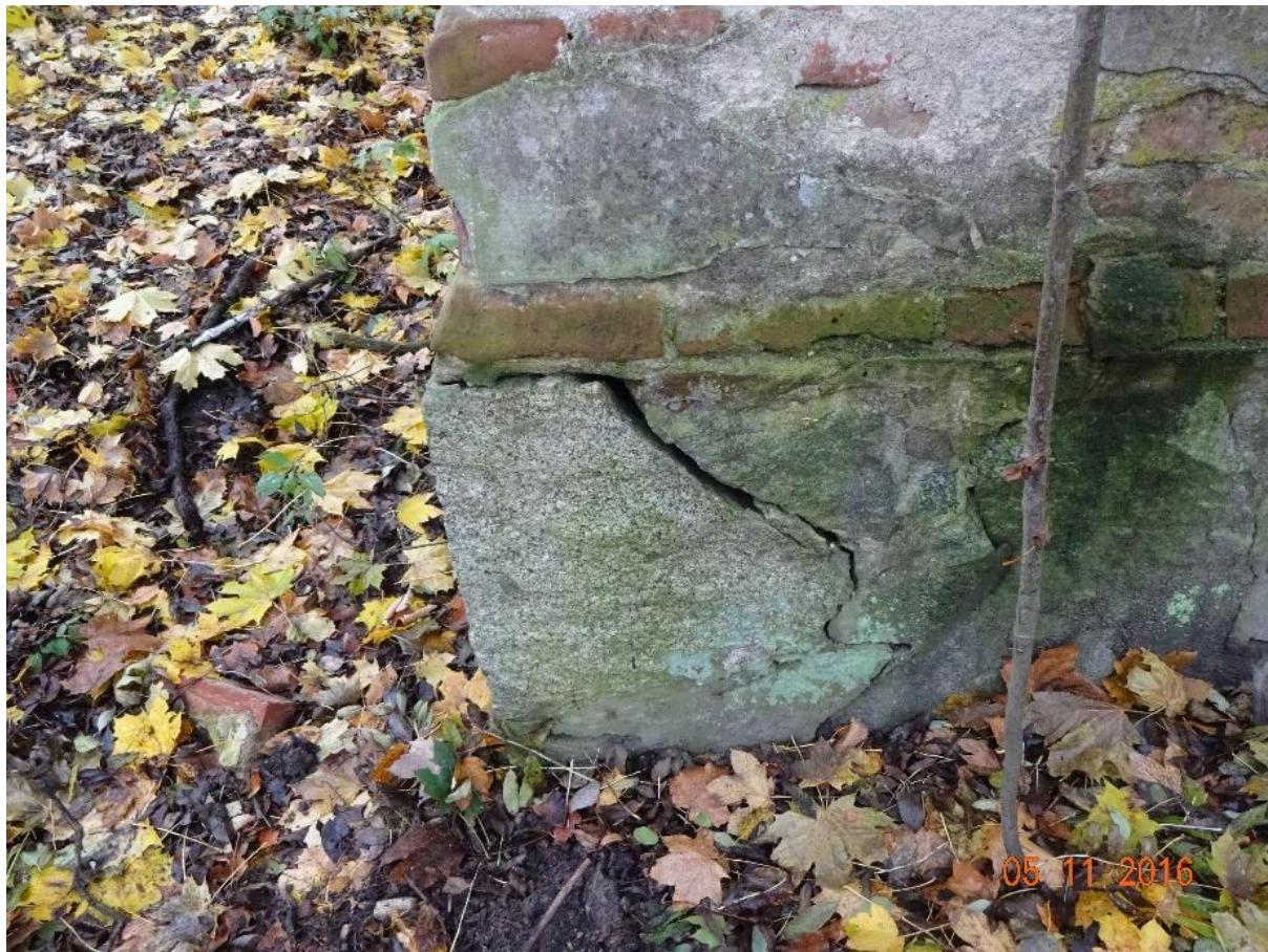
Fot. 8. Odspojenie kamienia polnego w narożu budynku
